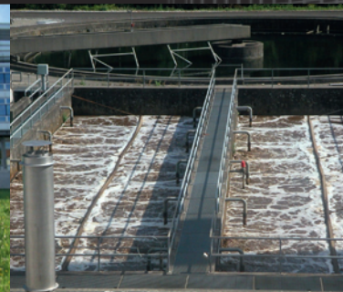
Klärbecken ARA, Au
